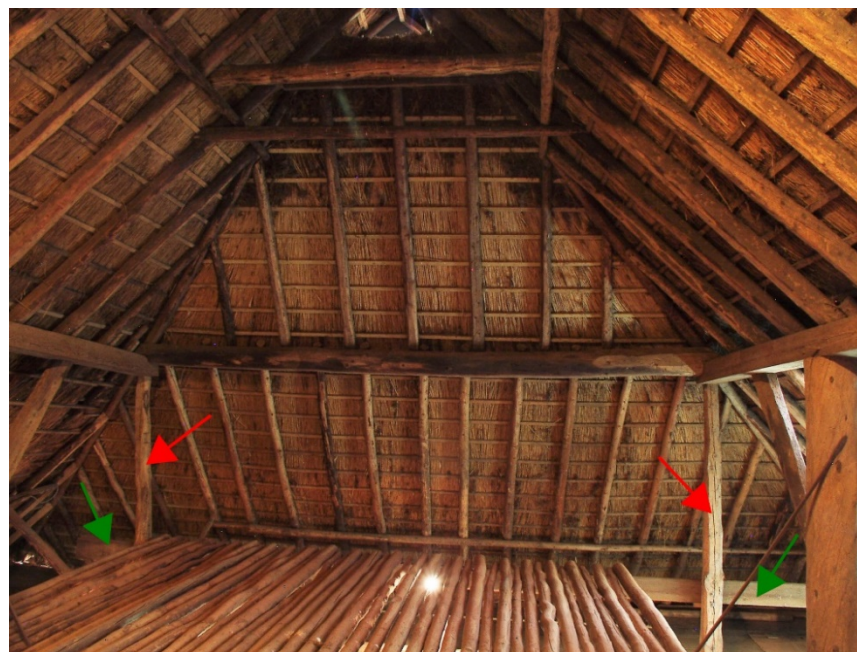
60. Onder de uiteinden van de gebintplaten en de dwarsplaat zou logischerwijs een laatste ankerbalkgebint moeten zitten – of op z'n minst een set robuuste stijlen. In plaats daarvan zijn twee dunne, hergebruikte eiken balkjes aangebracht (rode pijlen). Ze zijn verkeerd om geplaatst – het smalste uiteinde dient altijd onderaan te zitten – waarmee de indruk van een amateuristische ingreep wordt versterkt. Bij gebrek aan een ligger rusten de slieten op een provisorisch aangebrachte dwarsverbinding (groene pijlen).
