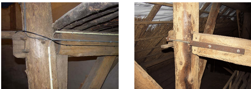
58 – 59. De slecht aansluitende verbindingen tussen stijlen en ankerbalken ogen weinig professioneel.
